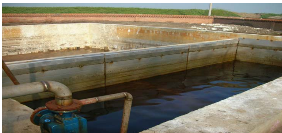
图 5-3 材质为白钢的工艺废水收集池
